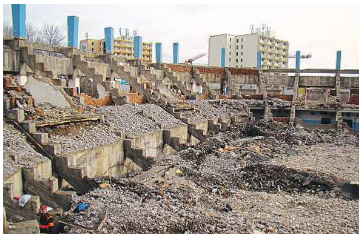
Ruina zimního stadionu trápi Teplice již řadu let. Vedení města striktně odmítá investovat do soukromého majetku. FOTO | ROMAN NEŠETŘIL
